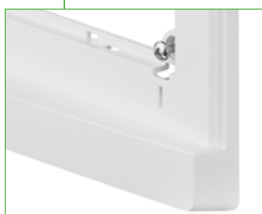
stiffened door frame
