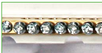
Terminal bar PE+N
